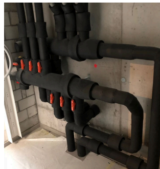
Technikraum: Verteiler der externen Kreisläufe
