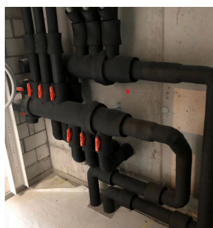
Sala técnica: colectores de los circuitos externos
