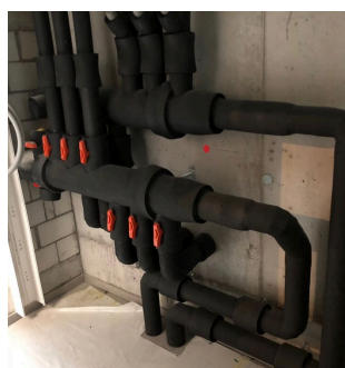
Local technique : distributeurs des circuits externes
